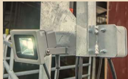
Steckdosen und LED Beleuchtung
